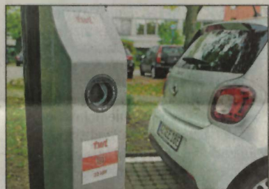
Die neue Ladesäule.
